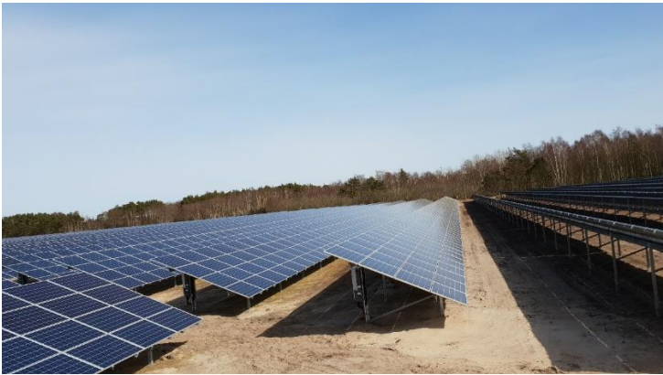
Foto 1: Solpaneler monteret på faste stativer
