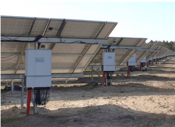
Figur 4: De hvide kasser under solcellerne er invertere, som omdanner jævnstrømmen til vekselstrøm
